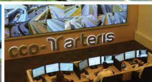
CCO: Centro de Controle Operacional da Arteris
